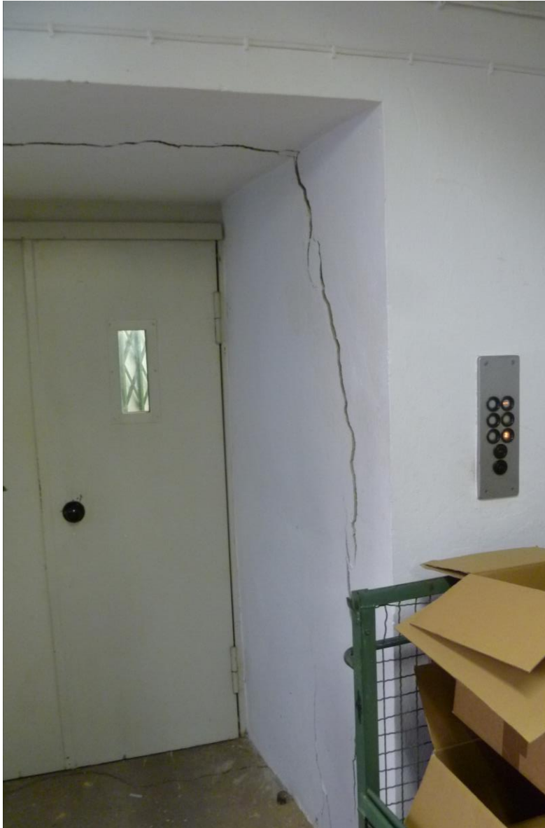
Abbildung 7-6 Rissbildung im Anbau eines unterfahrenen Gebäudes
