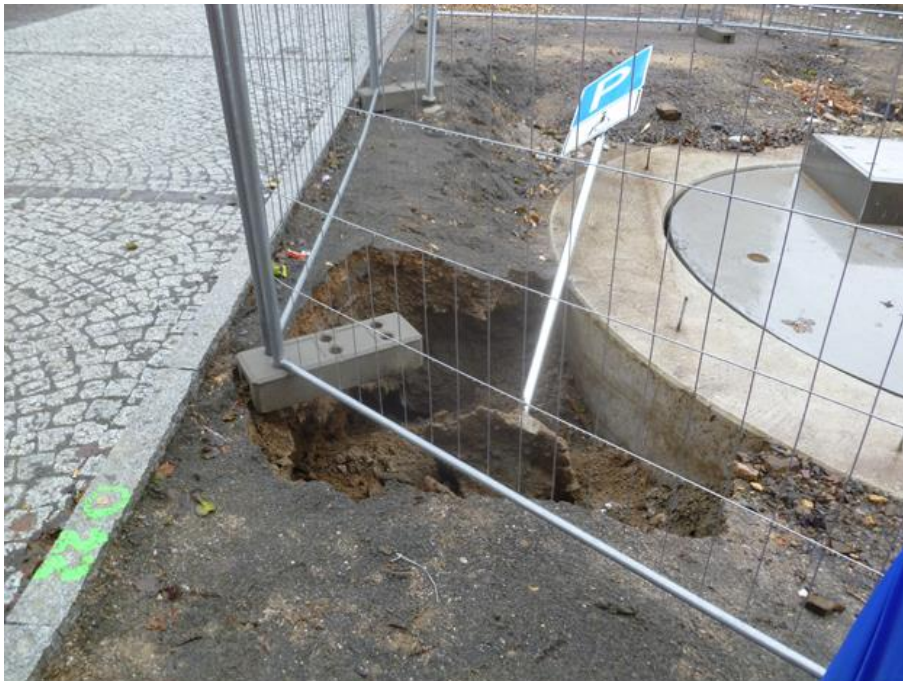
Abbildung 7-5 Geländeinbruch infolge Strangherstellung
