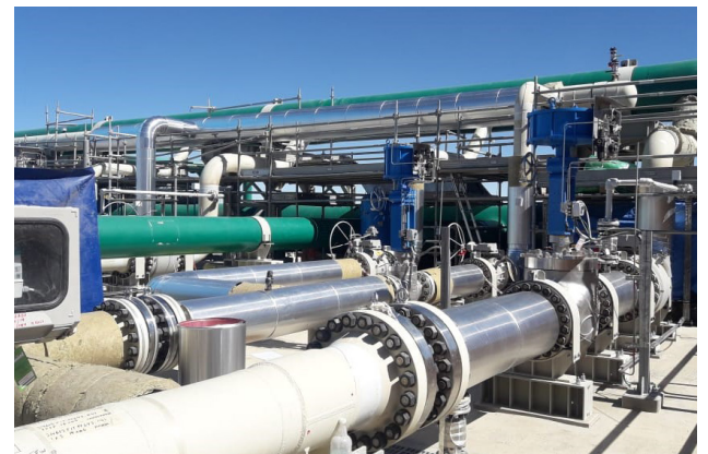
Proyecto Escondida Water Supply Chile
