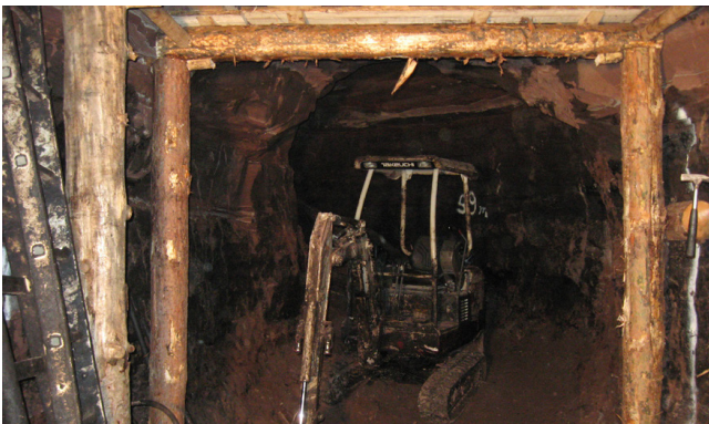
Sistema de túnel contaminado con alquitrán Jena, Alemania
