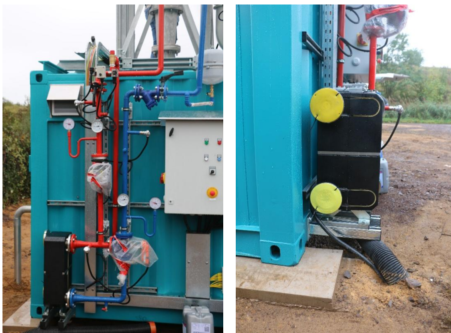
Abb. 5: Schwachgasbehandlungsanlage mit Wärmeauskopplung
